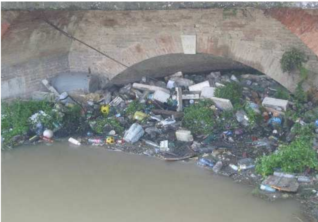
Immagine n. 37 - Una botte a sifone ostruita. L'eccessiva incuria provoca seri danni sulla rete idraulica. (Fonte: Pizzato – Rampado, 2002).
